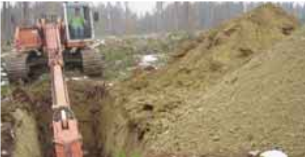
Abb. 4: Eine individuelle Bodenuntersuchung kann angezeigt sein, z. B. bei Verdacht auf Altlasten.
